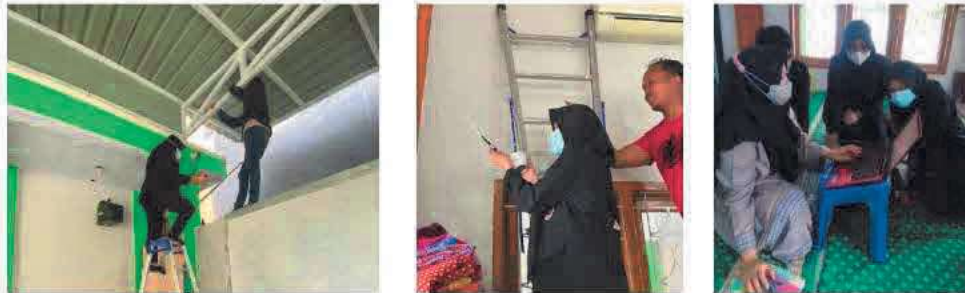
Gambar 7. Pemasangan kamera CCTV pada titik target dan proses instalasi aktivasi di wilayah masjid Raudhatul Jannah.
