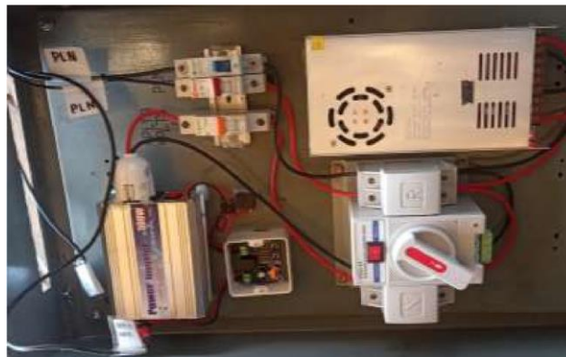
Gambar 2. Panel kontrol sistem kelistrikan aerator
