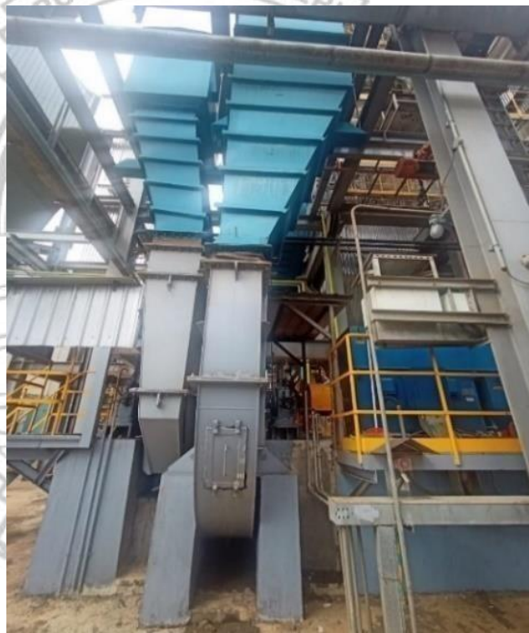
Gambar 2. 17 Secondary Air Fan (SAF) PLTU Mamuju 2x25 MW
