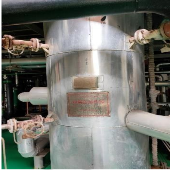
Gambar 2. 12 Gambar 2.14 HP Heater (sumber: PLTU Mamuju 2x25 MW)
