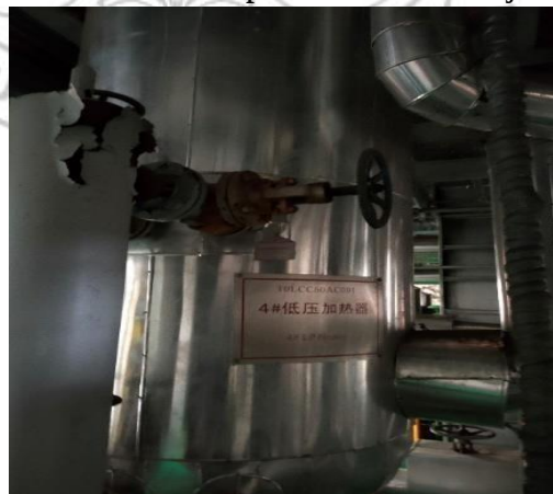
Gambar 2. 11 LP Heater (sumber: PLTU Mamuju 2x25 MW)
