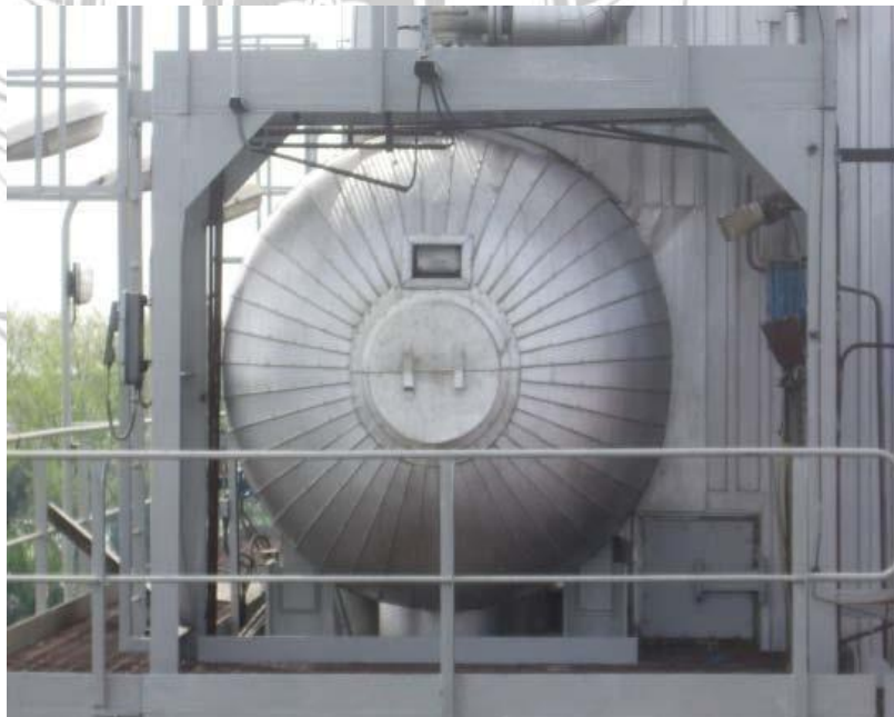
Gambar 2. 10 Boiler Drum (sumber: PLTU Mamuju 2x25 MW)
