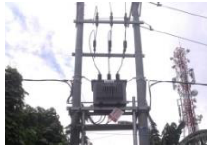
Gambar 6. Trafo Sisipan PT.ITR.048 Penyulang Tamalanrea
