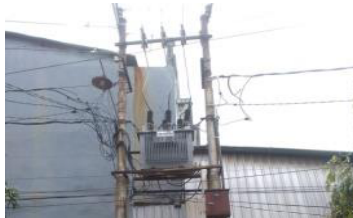
Gambar 4. Trafo Distribusi PT.ITR.024 Penyulang Tamalanrea
