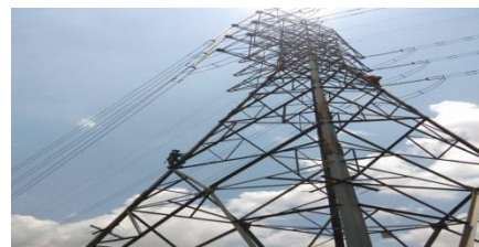
Gambar 1. Saluran Udara Tegangan Tinggi
