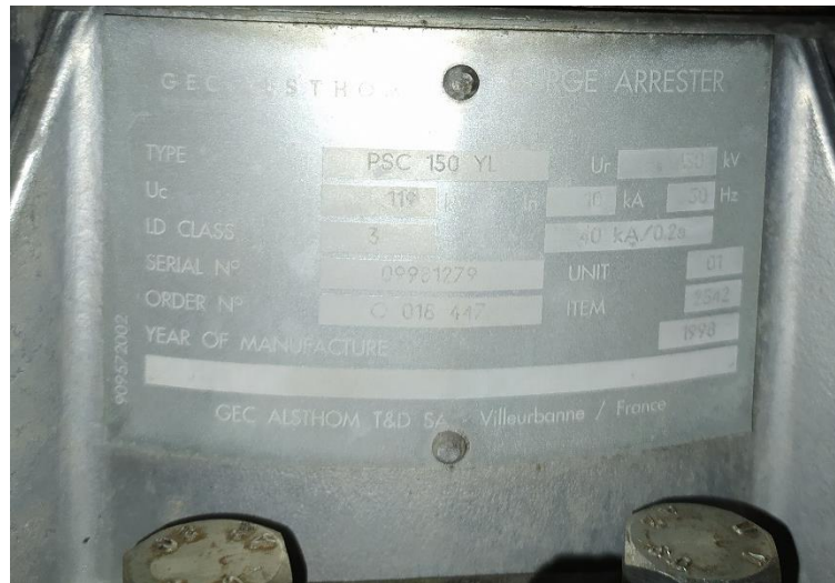
Lampiran 5. Nama plate lightning arrester pada transformator daya #1
