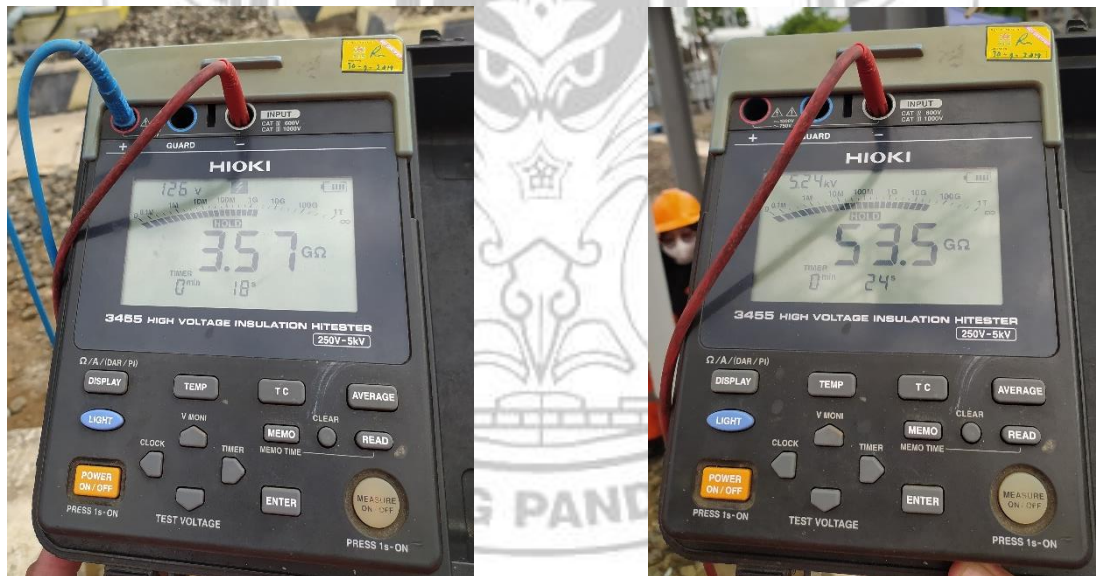
Lampiran 6. Dokumentasi hasil pengujian tahanan isolasi fasa R, S, T
